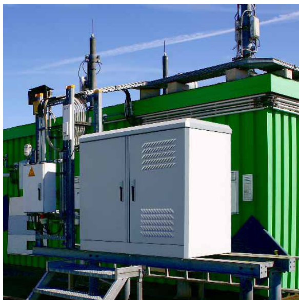
شکل ۱-۶: نمایی از یک تابلو بیرونی
