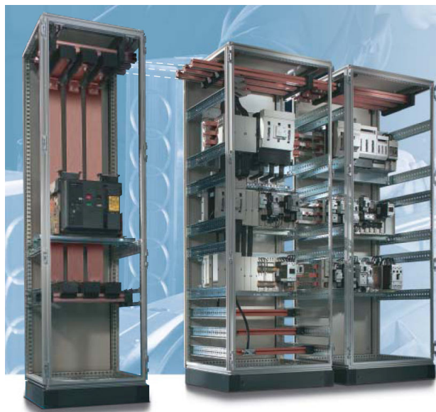
شکل ۳-۶: نمایی از یک تابلو توزیع
